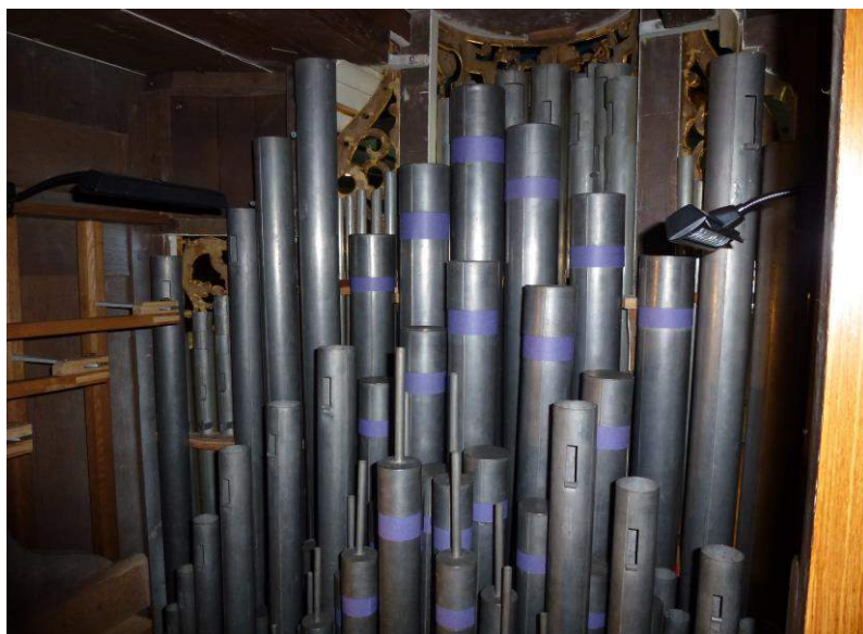
Een deel van het binnenpijpwerk
